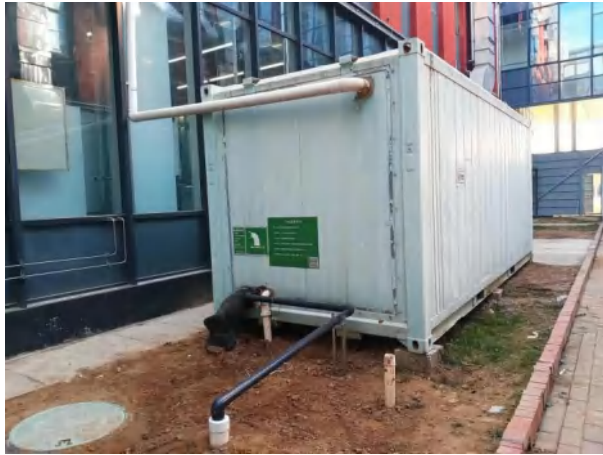
集装箱式废水处理装置外部
