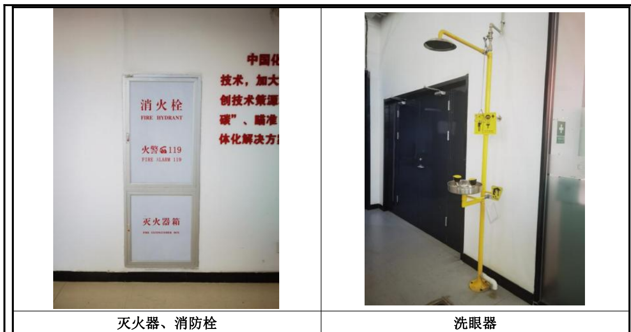
图 3-7 环境风险防范设施现状照片
