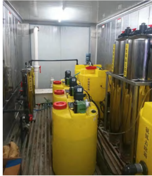
集装箱式废水处理装置内部
