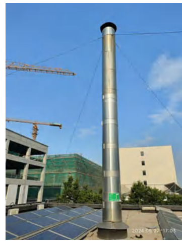
DA001排放口标识牌（远景）
