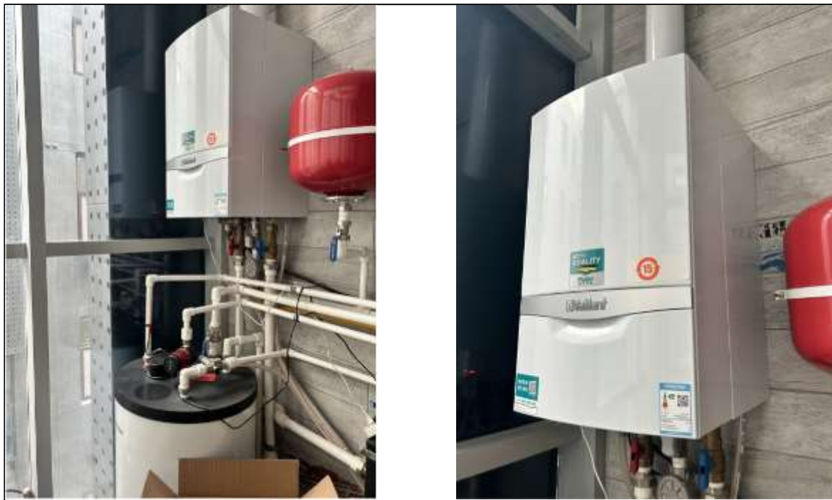
图3-1 采暖热水炉现状照片
