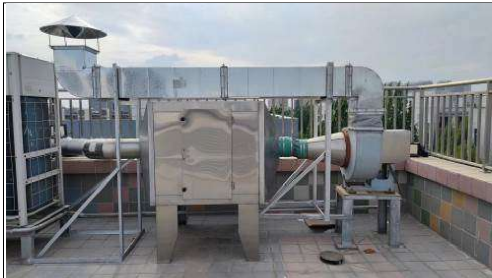
401 所在建筑楼顶活性炭吸附装置及排气筒
