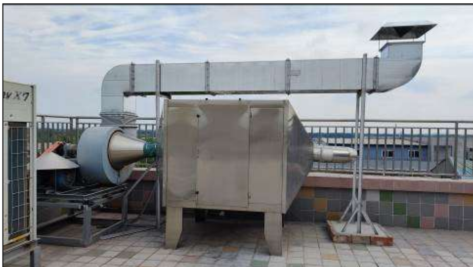
402 所在建筑楼顶活性炭吸附装置及排气筒
