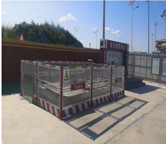
图 6 项目施工期沉淀池照片
