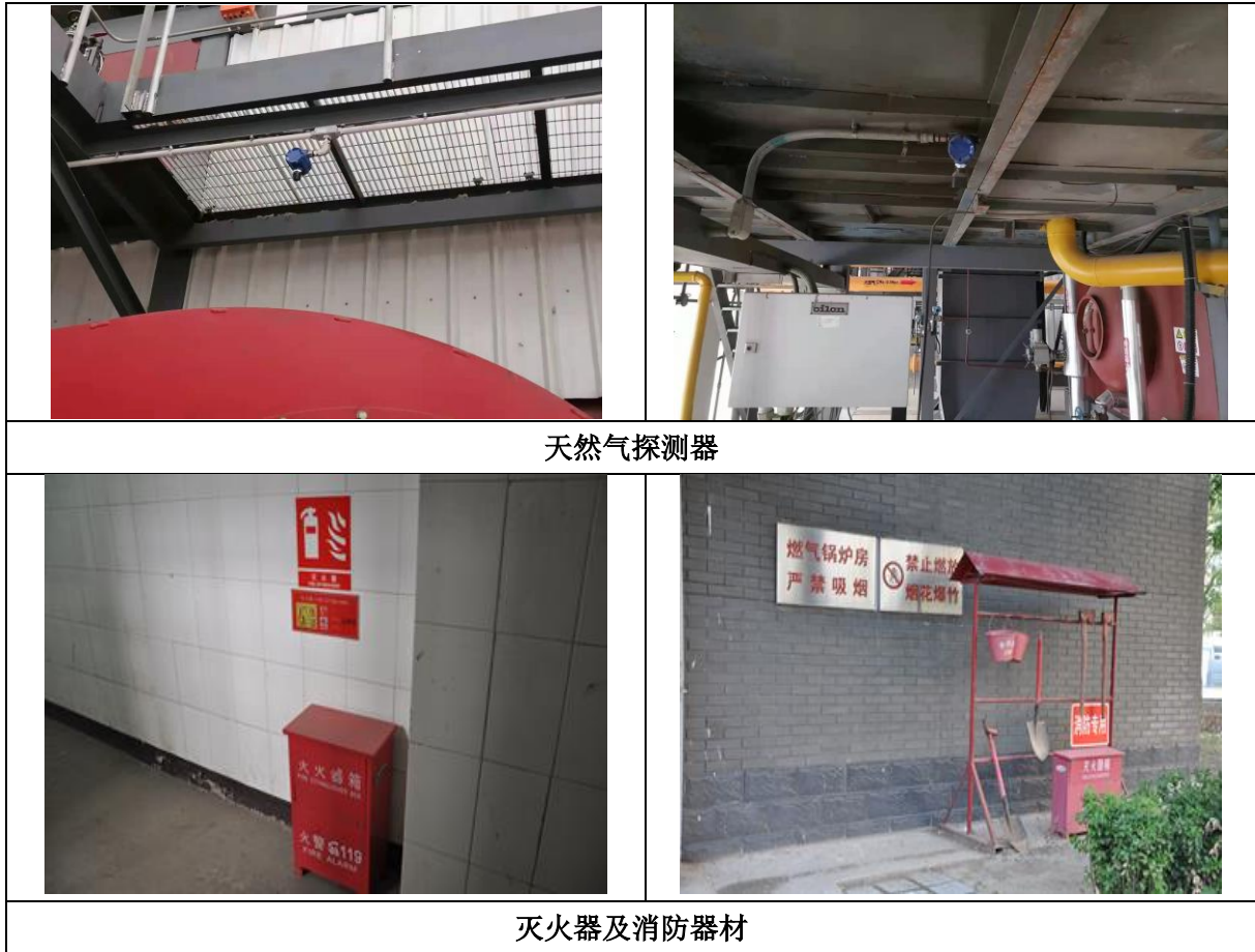
图 3-4 风险防范设施照片
